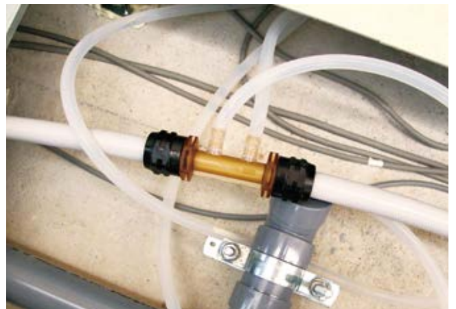
病室床下分岐配管
