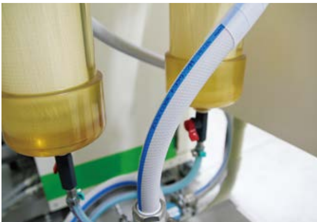
装置まわり配管
