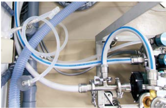
装置まわり配管
